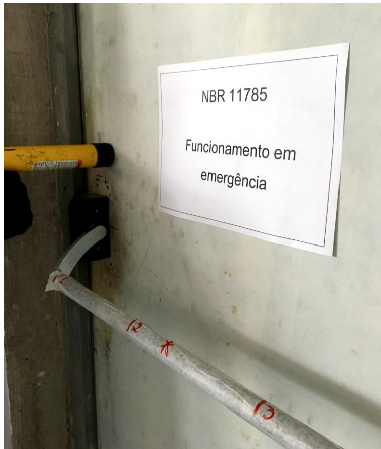
Foto n.º 04 – Visualização do ensaio verificação de funcionamento em emergência
